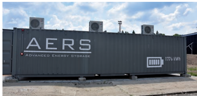
Veľkokapacitné batériové úložisko SAS
