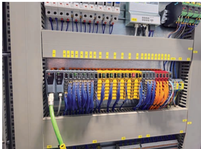
Žlté moduly riadiaceho systému X20 strážia bezpečnosť celej technológie.
