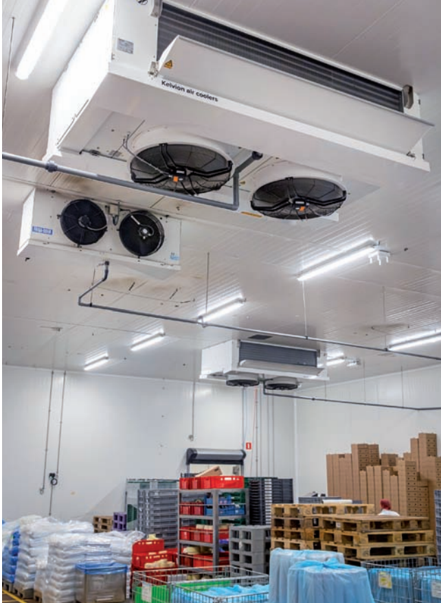
Zariadenie na stropné chladenie s ventilátormi
