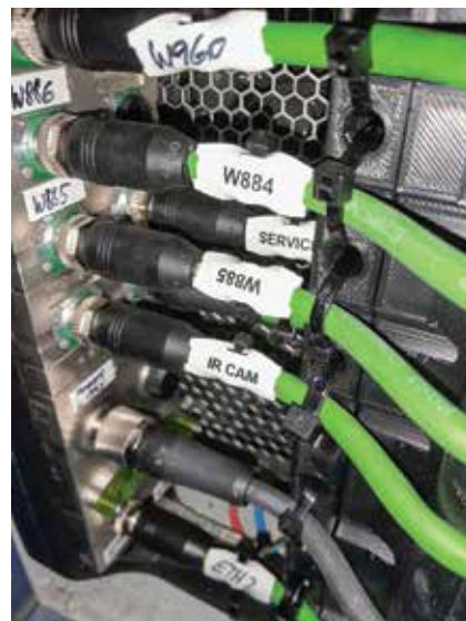
Obr. 2 Vzhľadom na náročné podmienky v podzemí sa počas testovacej prevádzky opakovanne vyskytovali poruchy a výpadky spojenia medzi riadiacimi jednotkami a rôznymi snímačmi a akčnými členmi. Odkedy spoločnosť VirtuRail stavila na vysoko odolné spojovacie komponenty s triedou ochrany IP67 od spoločnosti Murrelektronik, tieto problémy sú minulosťou. (Foto: VirtuRail)
