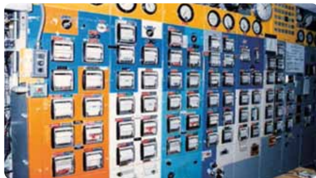
Obr. 2 Stena s prístrojmi
