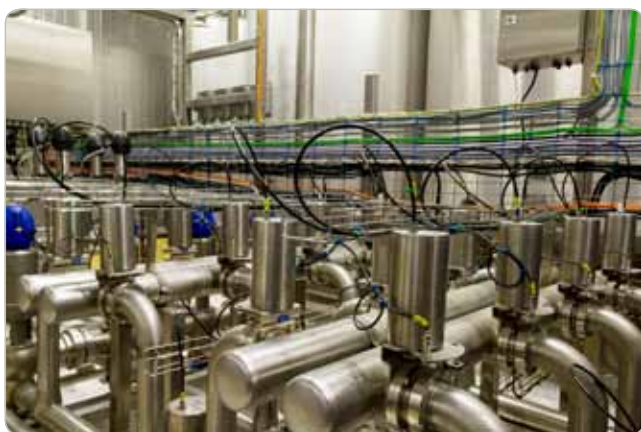
Obr. 3 Ventilové bloky, ktoré sú ovládané ventilovými ostrovmi Festo cez Profinet
