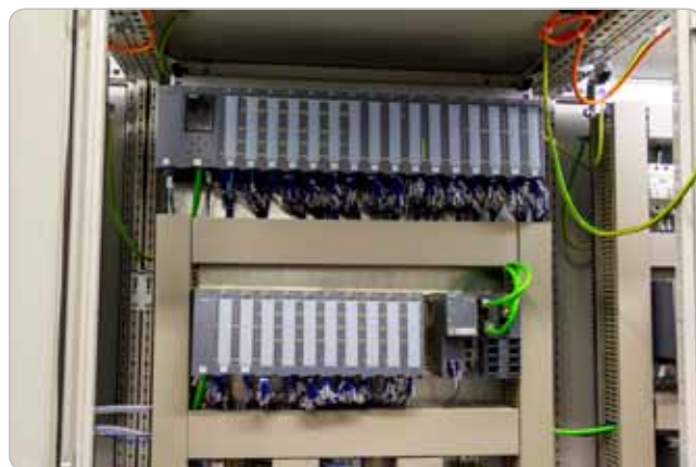
Obr. 4 Riadiaci systém Siemens S7-1500
