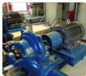
Obr. 1 Nové motory na zmodernizovaných čerpadlách v úpravovni vody Sneece Pond
