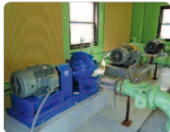
Obr. 2 Nové motory a čerpadlo v prečerpávacej stanici Booster. Nové motory osadené frekvenčnými meničmi boli nasadené na všetkých troch čerpadlách na tejto stanici, pričom jedno čerpadlo (natreté na modro) bolo nahradené menším čerpadlom vhodnejším pre menšie prietoky.
