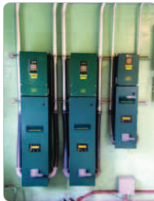
Obr. 3 Tri nové frekvenčné meniče v prečerpávacej stanici Booster
