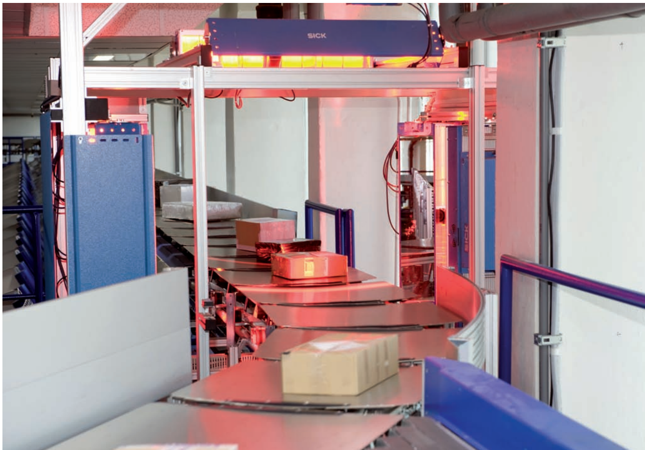
Tunelový skener zosníma pri rýchlosti cca 1,5 – 1,7 m/s čiarový kód umiestnený na každom balíku a posiela tento údaj na databázový server.
