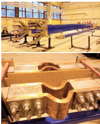
Zapuzdrené vodou chladené vodiče (hore) a ich prepojenie (dole)
