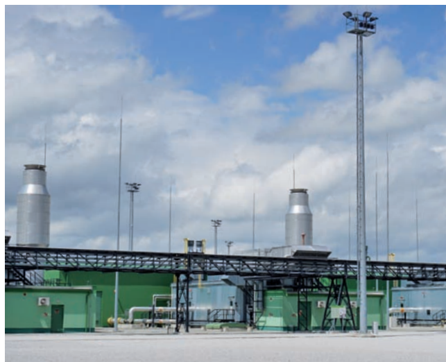
Zachytávacie stožiare slúžia na zabránenie priameho zásahu blesku do technologických zariadení, v okolí ktorých je zóna s nebezpečenstvom výbuchu
