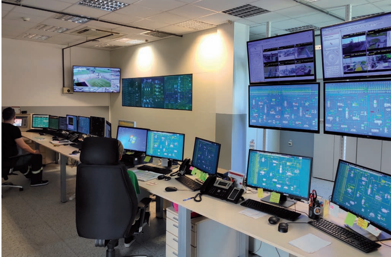
V miestnosti riadenia sledujú operátori všetky potrebné údaje o prevádzkových veličinách, stav ventilov a zároveň majú možnosť vzdialeného riadenia jednotlivých technológií
