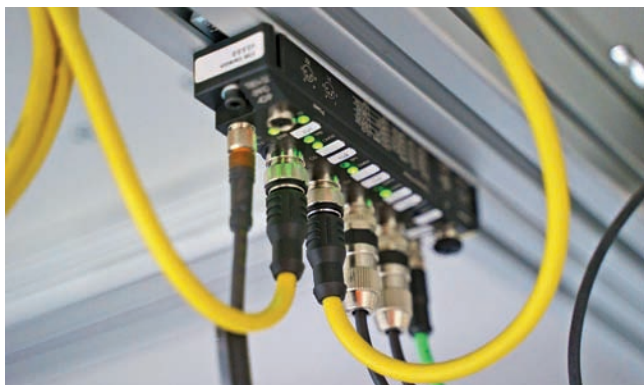
Rozhranie TBEN-S-RFID od spoločnosti Turck komunikuje tak cez Profinet s PLC Siemens, ako aj cez Ethernet/IP, čím vytvára rozhranie pre Labview bežiacom na prepracovanej stanici.
