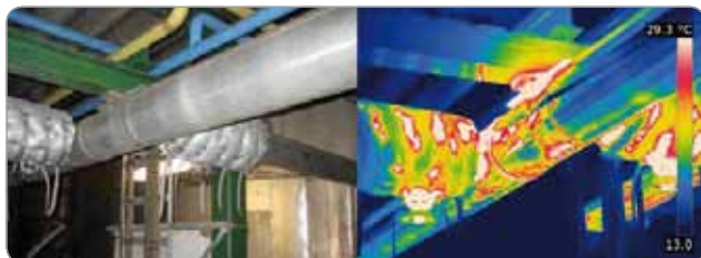
Obr. Tepelné straty z dôvodu chybné izolácie je na termovíznych snímkach zreteľne vidieť.
