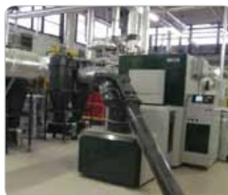
Obr. 6a Centrálny zdroj tepla Trenčianske Teplice Inštalovaný výkon 2x800 kW
