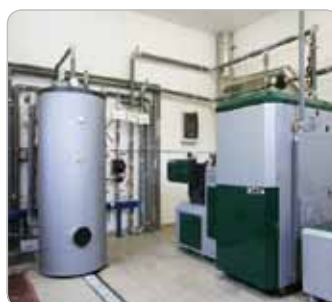
Obr. 5b Kotelňa na pelety, menovitý výkon 90 kW
