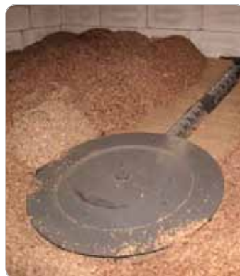
Obr. 4b Pružinové miešadlo v sklade štiepky, menovitý výkon 150 kW
