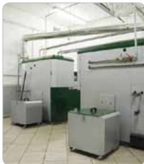
Obr. 3b Kotelňa ZŠ Korňa, dva kotly
