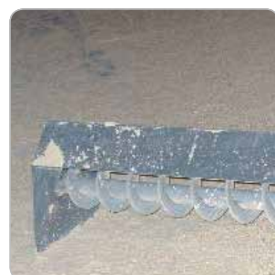
Obr. 5c Peletový dopravník v sklade paliva v bytovom dome v Lubochni
