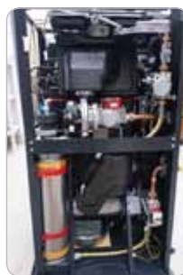
Obr. 3 Pohľad dovnútra mikrokogeneračnej jednotky
