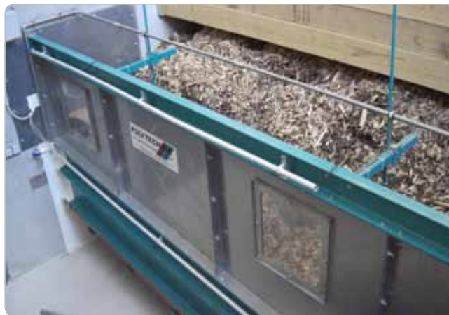
Obr. 11 PVA Alland, HVR 800 kW - Dopravník paliva s hydraulickým pohonom (zdroj: Polytechnik GmbH, Weissenbach a.d. Tr., Rakúsko - 2009)
