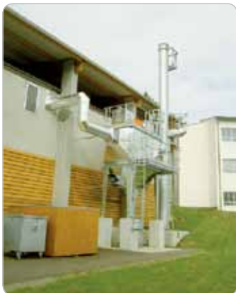
Obr. 14 PVA Alland, HVR 800 kW - Elektrofilter (zdroj: Polytechnik GmbH, Weissenbach a.d. Tr., Rakúsko - 2009)
