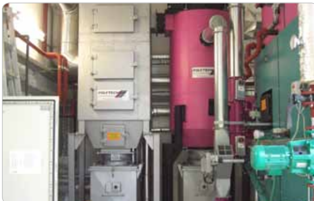
Obr. 13 PVA Alland, HVR 800 kW - Odlučovač TZL a LUVO (zdroj: Polytechnik GmbH, Weissenbach a.d. Tr., Rakúsko - 2009)
