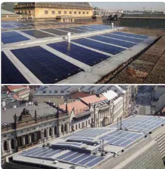
Obr. Fotovoltaická elektráreň na strechách prevádzkovej budovy a budovy Novej scény
