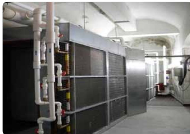
Obr. Rekuperácia tepla odvádzaného vzduchu z vetrania javiska a hľadiska historickej budovy
