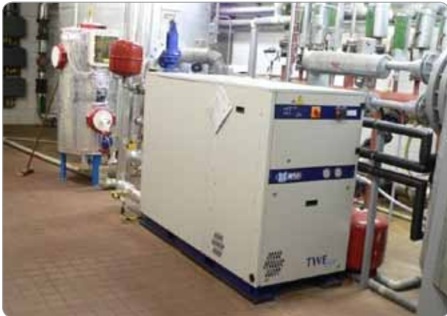
Obr. Malé tepelné čerpadlo využíva odpadové teplo z javiskovej technológie na ohrev teplej úžitkovej vody.
