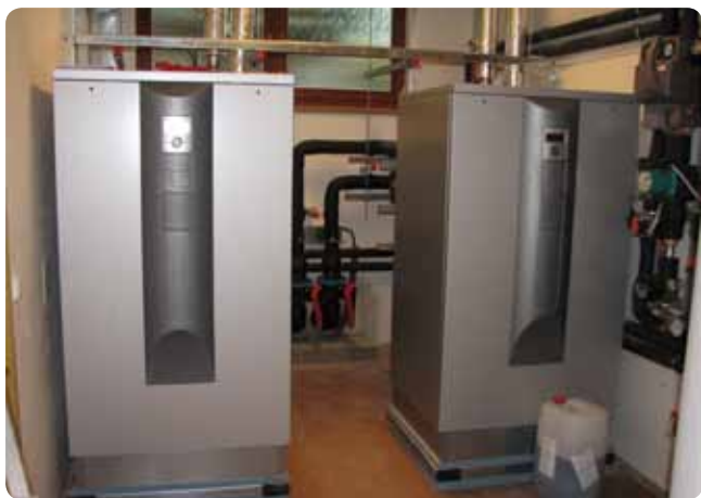
Obr. Kotelna s tepelnými čerpadly
