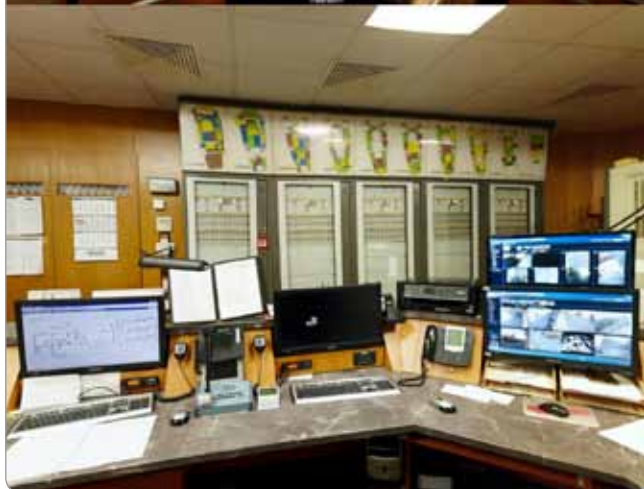
Obr. Centrála riadenia technológií divadla
