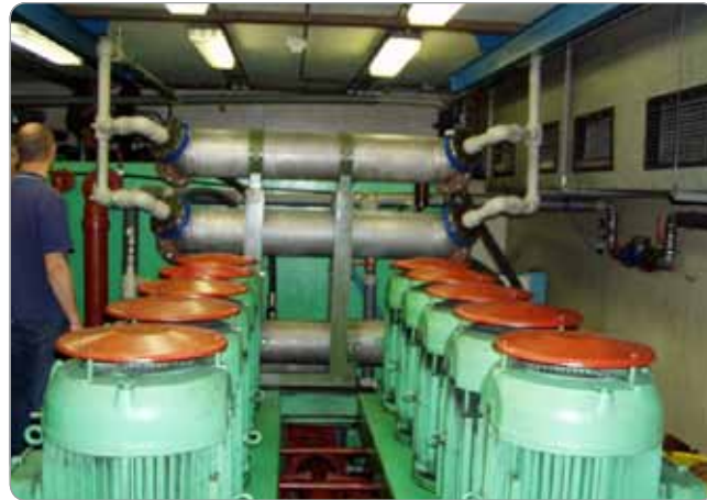
Obr. Strojovňa javiskovej hydrauliky
